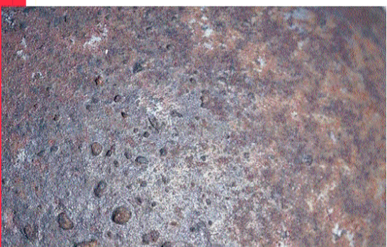
Corrosion généralisée (aspect après grenaillage)
