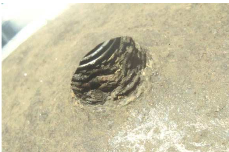
La corrosion galvanique du filetage conduit à la mise au rebut de la bouteille
