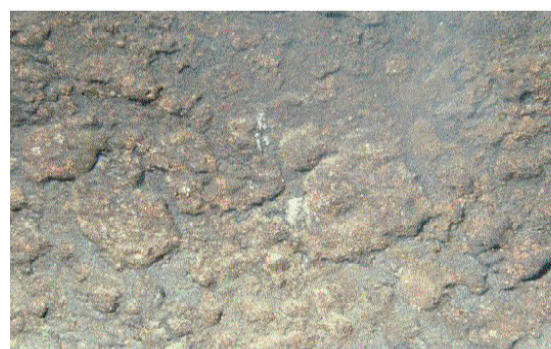
Corrosion généralisée (aspect après grenaillage)
