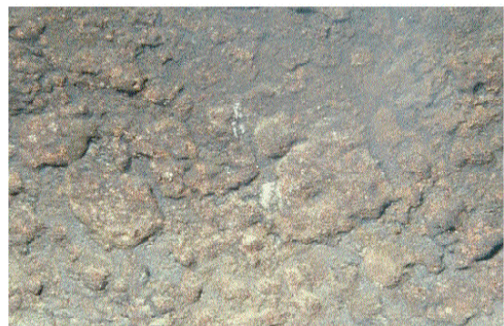
Corrosion généralisée (aspect après grenaillage)
