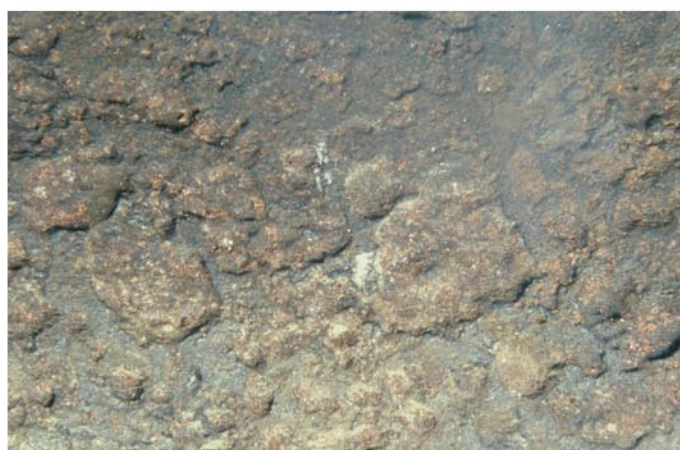
Corrosion généralisée (aspect après grenailage)
