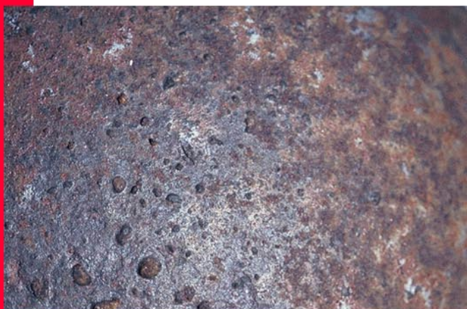
Corrosion généralisée (aspect après grenailage)
