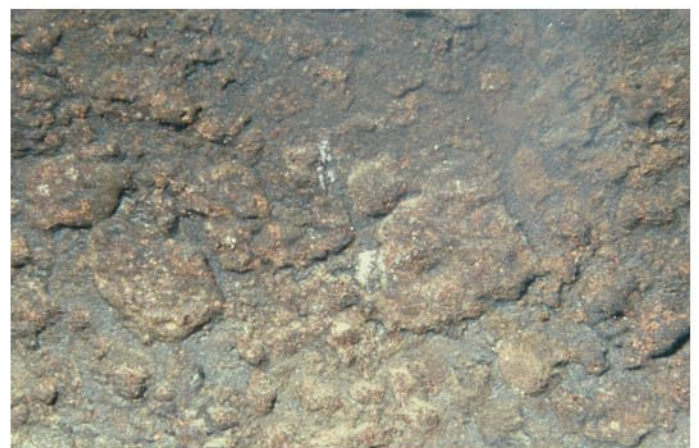
Corrosion généralisée (aspect après grenaillage)
