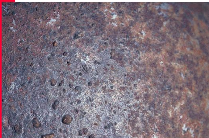
Corrosion généralisée (aspect après grenaillage)
